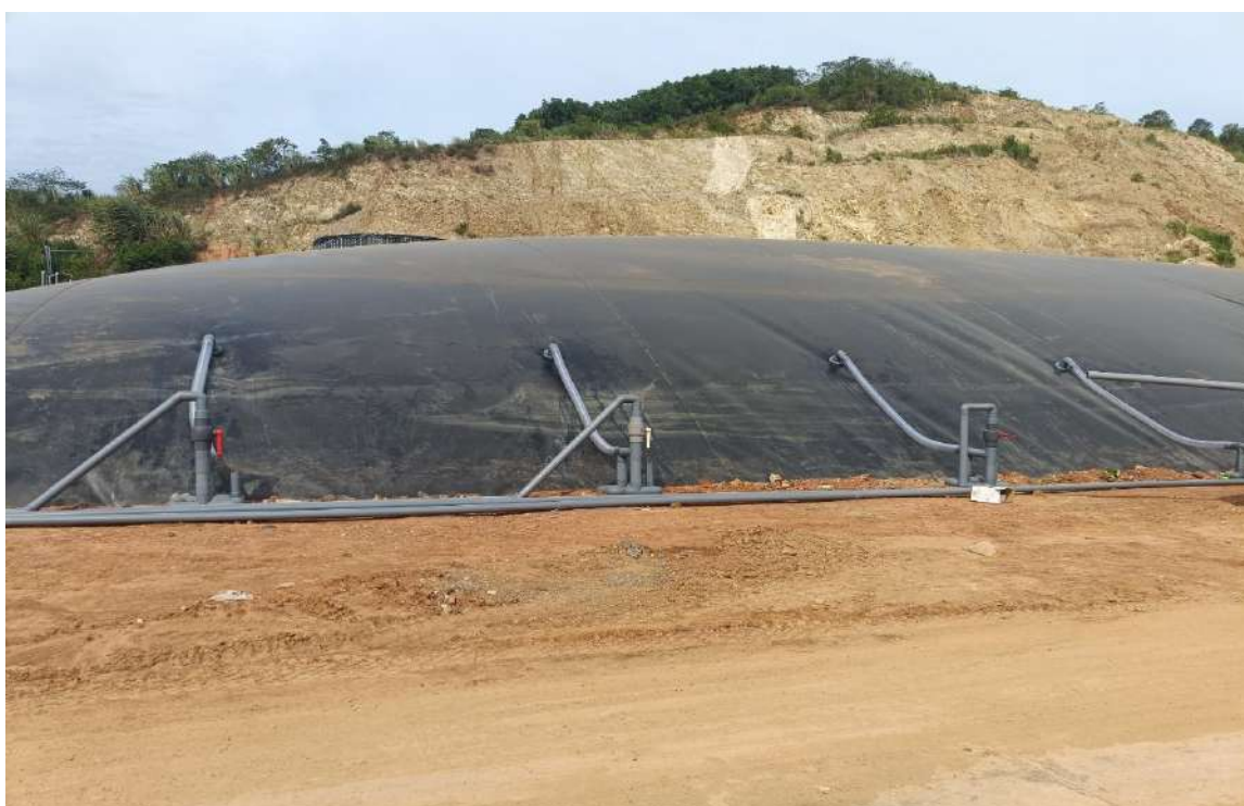
Hình 3.12. Hình ảnh hệ thống thu gom khí từ bể biogas
