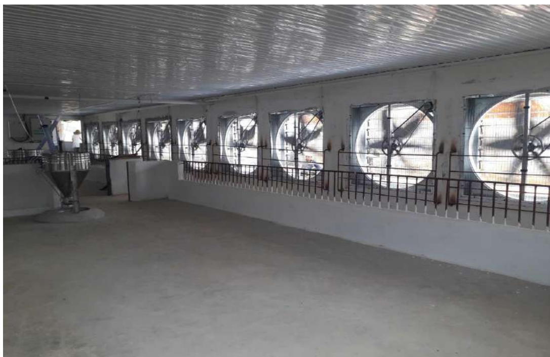
Hình 3.14. Quạt thông gió được lắp đặt tại các chuồng nuôi.
